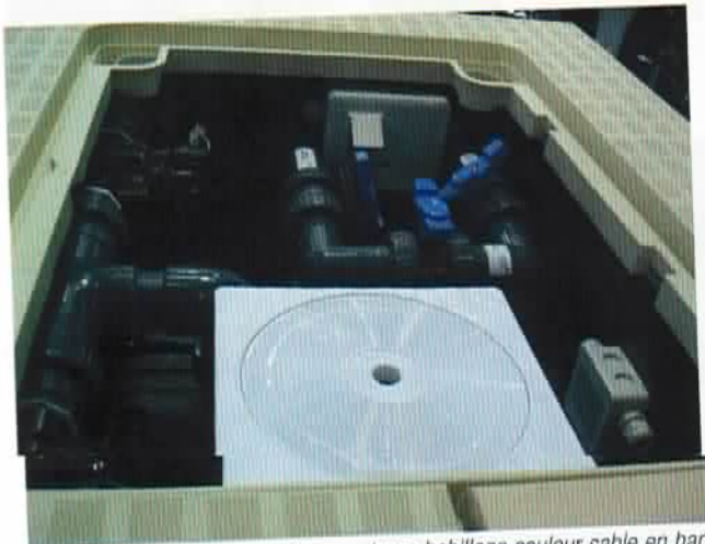
1,20 x 1 m pour ce bloc qui comporte un habillage couleur sable en harmonie avec la margelle. Totalement sécurisé par une trappe avec fermeture, il abrite : la pompe, un projecteur de 300W, deux buses de refoulement, un pré-équipement chauffage, un filtre à cartouche et la possibilité d'installer un système de nage à contre-courant. Bloc technique MX75 de Mondial Piscine.
